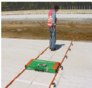
MIT Scan-2 trials at a South Carolina DOT installation.
